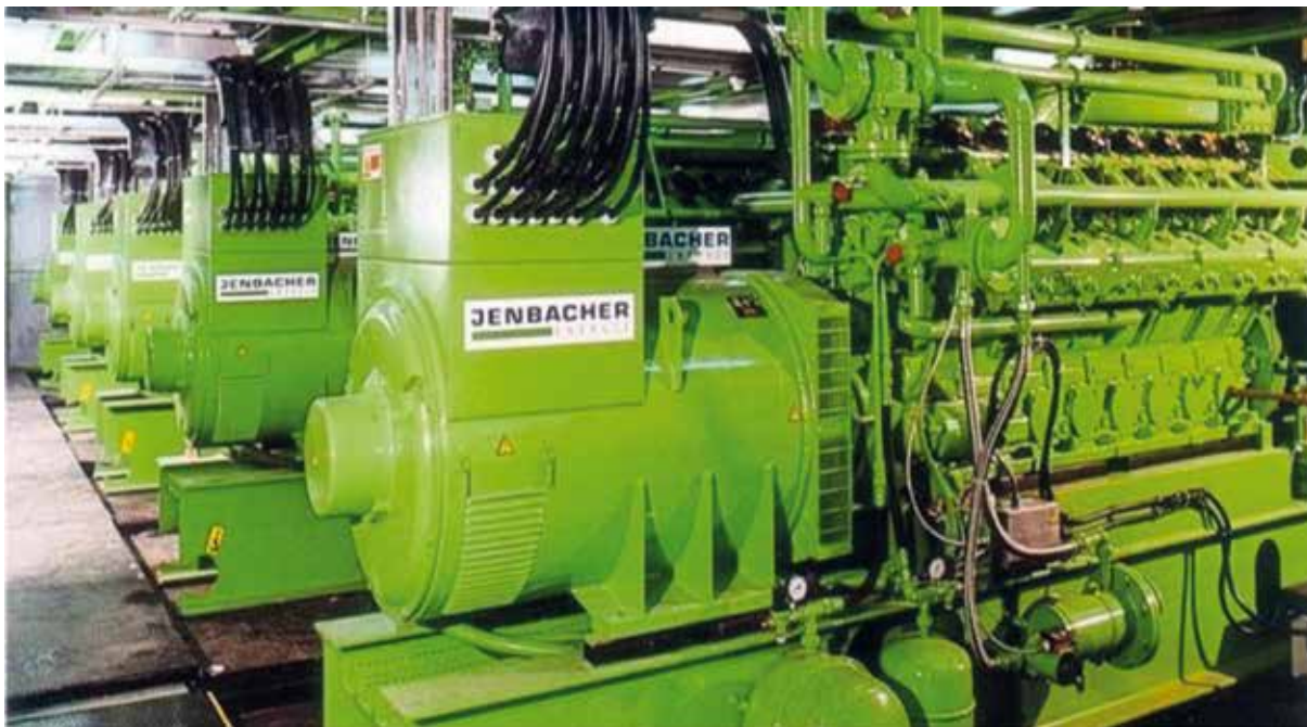
Obr. 19: Získavanie skládkového plynu zo starej skládky komunálneho odpadu vo Viedni s kapacitou výroby elektrickej energie 7,9 MWh, [1].
